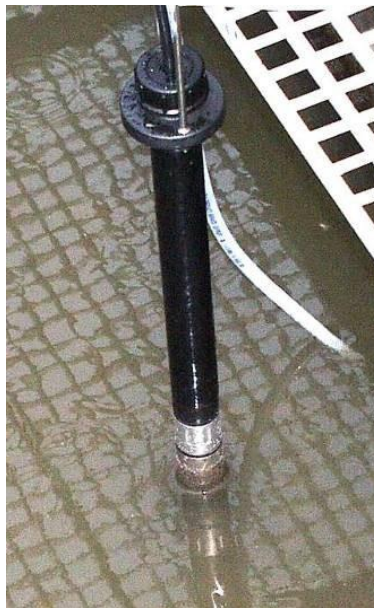
図12 活性汚泥槽に設置した VARiON®Plus 700 IQ
