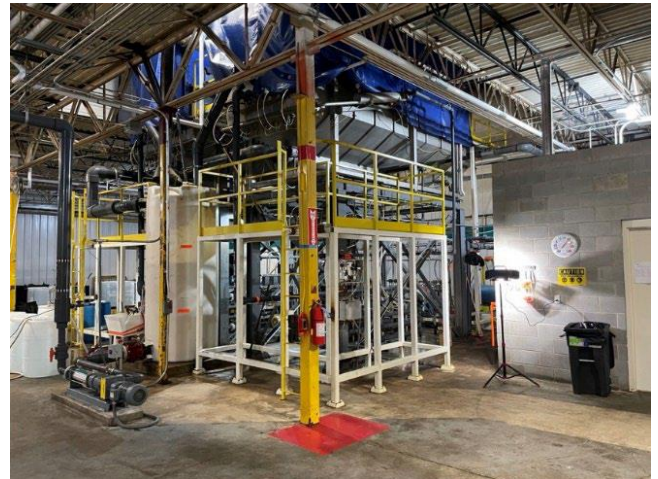
図1. ローウェルのLitehouse社の排水処理設備
