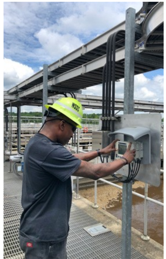
Western Branchでは、Lydell WashingtonがIQSN 2020 3Gコントローラーで栄養塩測定値をリアルタイムでチェックします。
